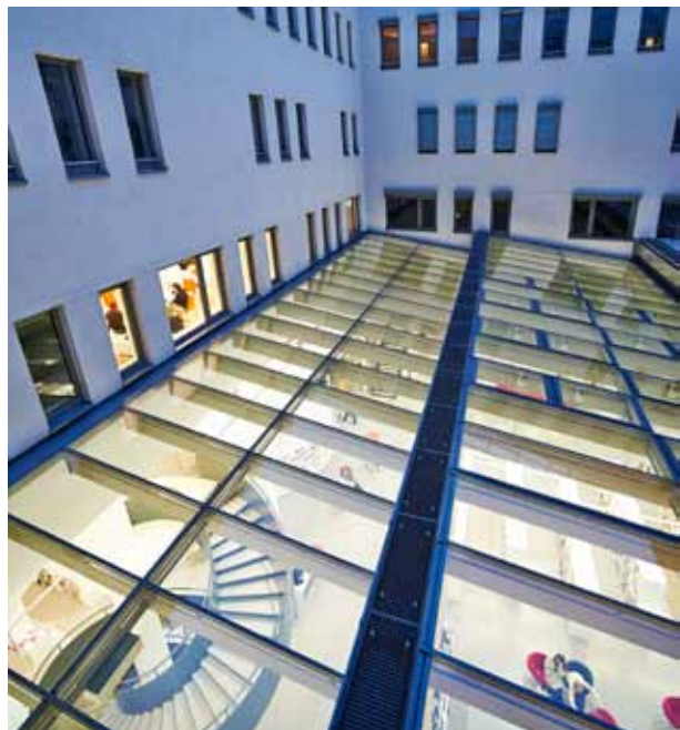
SLB_pic_11: Die G30-Brandschutzverglasung aus PYRAN® S und dem Stahlprofilssystem Jansen VISS Fire überdacht eine Fläche von rund 250 m 2 .
