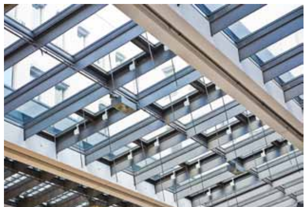
SLB_pic_07: Realisiert wurde die weitgespannte Konstruktion als G30-Brandschutzverglasung aus PYRAN® S von SCHOTT Technical Glass Solutions und dem Stahlprofilsystem Jansen VISS Fire.
