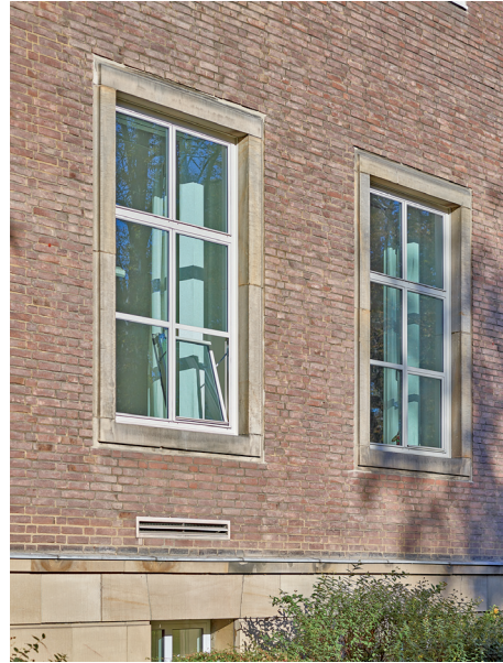
pic_04_MS LWL_CF012917.tif: Der Lüftungsfügel, beim Originalfenster im obersten Feld angeordnet, wurde bei der Rekonstruktion nach unten verlegt, um die Handhabung zu erleichtern.
